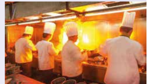
Automatische Frittier-Löschanlage, Marke ANSUL (Quelle: www.gamatronik.de).
