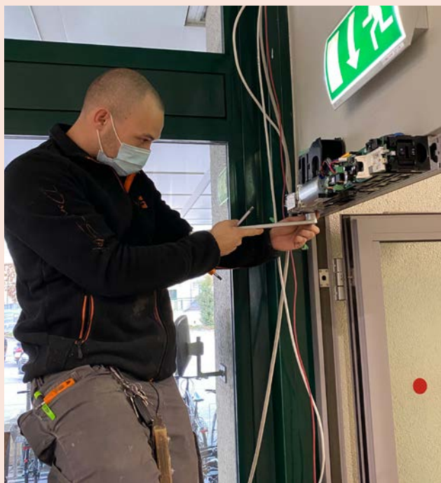
Dringende Instandsetzungsarbeiten sind durchzuführen!
